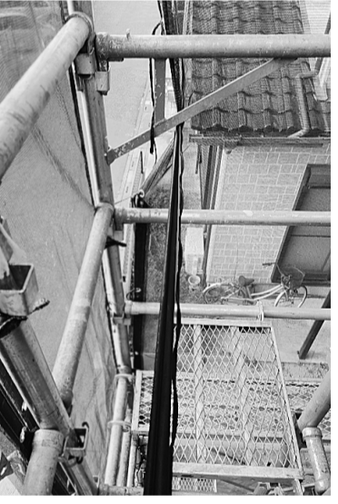
保護がされていない電線
