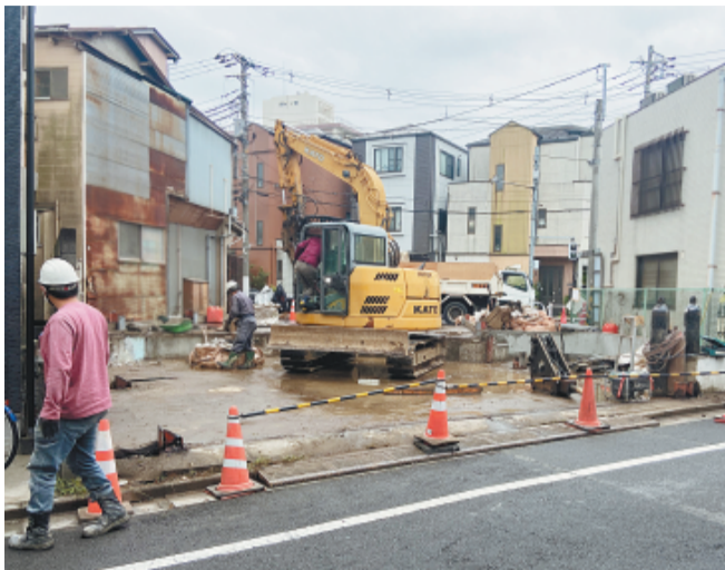
広さ32坪。22年10月3日から解体工事開始。解体に20日、基礎工事はひと月を要しました
