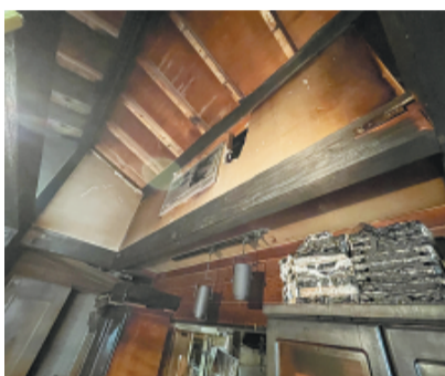
消火の際、天井は壊され屋根裏が剥き出しに
