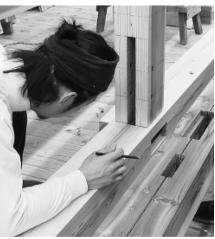
23期生の実習棟実習。柱と梁の接合部を確認中。仲間と一緒に、図面を読み取り、手刻みで2階建て木造軸組住宅をつくる体験は感動を生む
