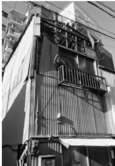
屋根が抜けた空き家
